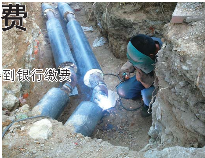
城建花园小区的供热管网正在进行维修改造。本报记者 刘涛 摄
