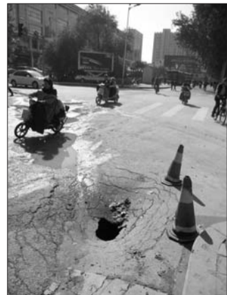
该路段人流量大,大坑非常危险。 本报记者 张汝树 摄
