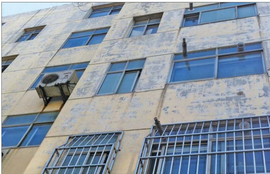
有些小区无法集中供暖,不少业主选择了烧天然气壁挂炉取暖。图为在城区双力小区,天然气壁挂炉的烟囱从不少住户中伸出。 本报记者 张召旭 摄
