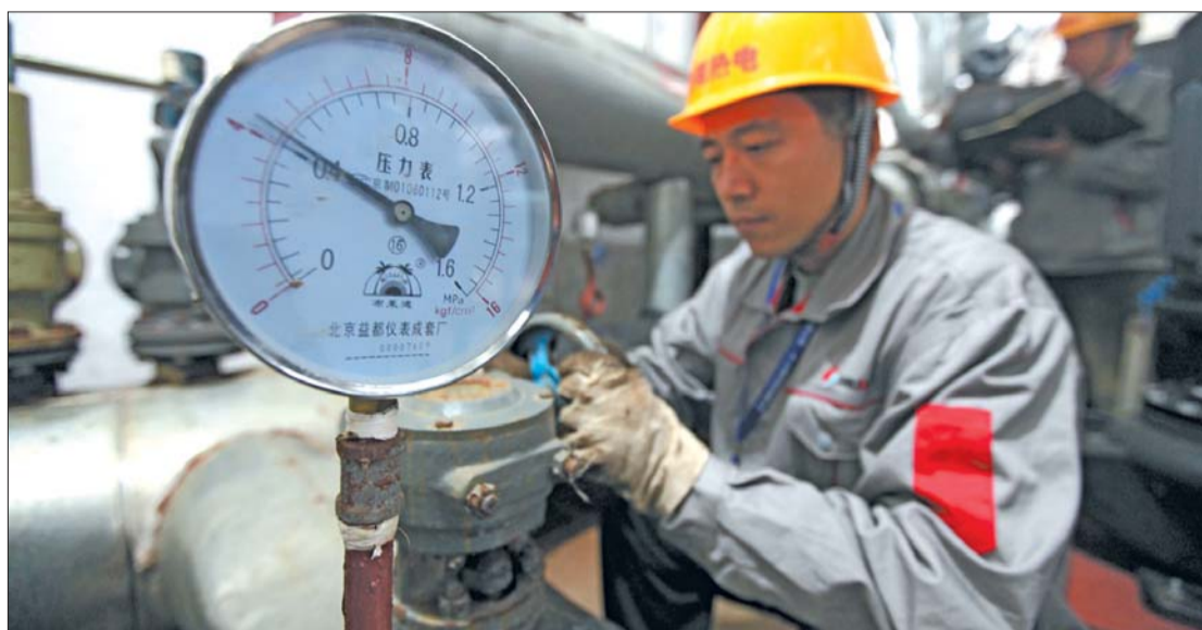
▲22日,济南热电公司山景明珠班组工作人员正在检修管网,供暖季即将开始,工作人员每天要跋涉十几公里维护供暖管网安全。 见习记者 霍英杰 摄
