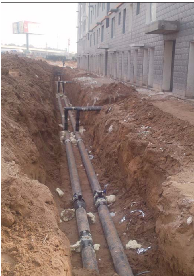
22日,翟时社区正在进行管道外保温施工。本报记者 贺莹莹 摄
