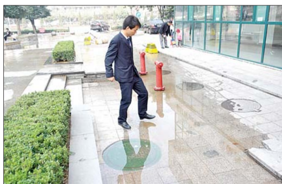
在鑫苑国际城市花园小区北门,自来水从破裂的管道流出,形成了一片水域。 见习记者 郭凯 摄
