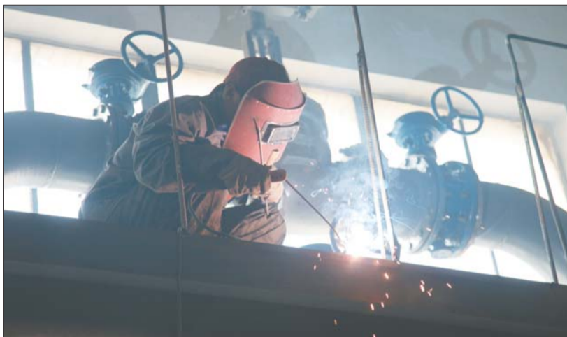
热力公司工作人员正在燕山锅炉房焊接管道,把和平路主管网和燕山片区供暖连接起来。 本报记者 蒋龙龙 摄
