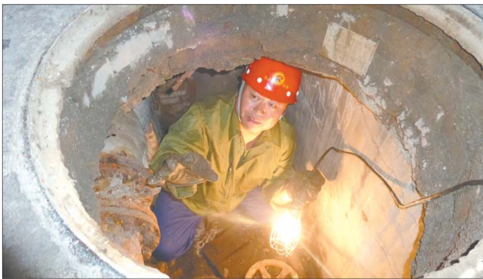
济南热力公司开始对东部城区引汽暖管,山东省劳模、济南热力公司供热三公司供热服务处主任王忠林正在管道井内调整阀门。
