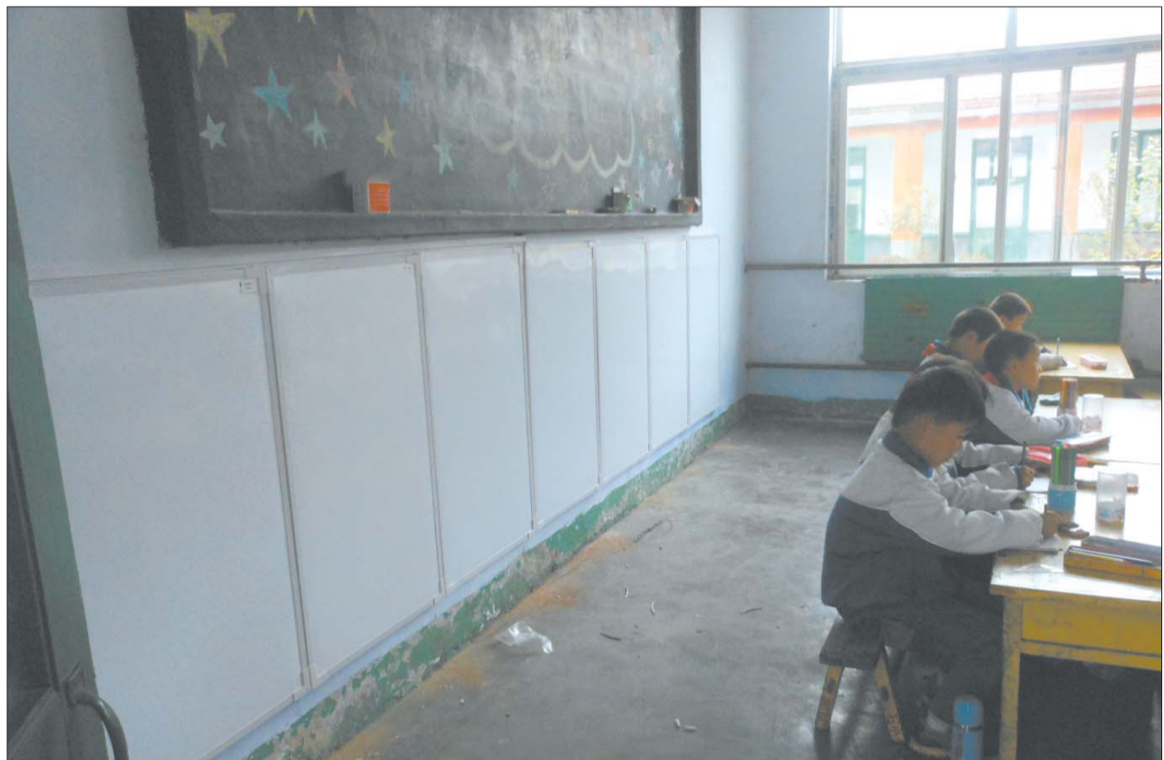
七块电热板都安装在教室后墙上,既美观又不占地方。 本报见习记者 杜彩霞 摄
