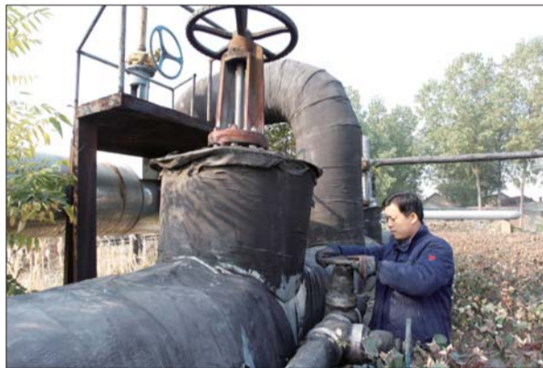
环保供热的工作人员开启蒸汽热源总阀门。 本报记者 王鑫 摄
