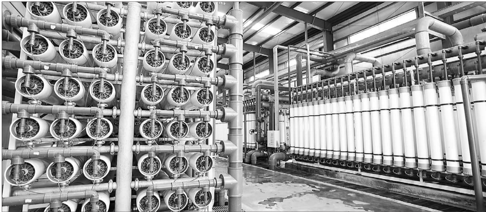
▲耀华鲁信为莱钢提供的综合污水处理项目。
