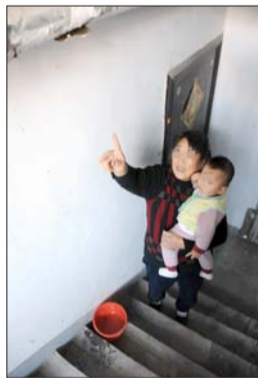
二毛社区西区5号楼2单元的居民在楼梯放了一个小桶接供热管道里滴下的水。 本报记者 王鑫 摄
