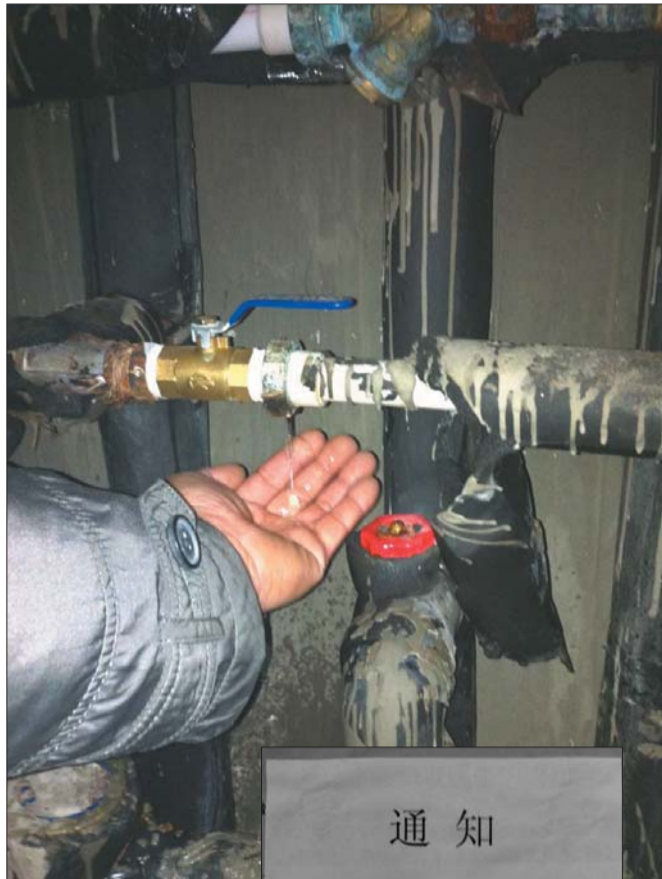
阀门没了,楼道里的管道不停地漏水。
