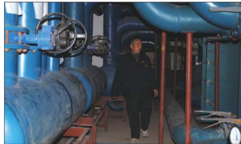
某小区物业人员正检查二级供热站设备运行状况。本报记者 崔如坤 摄
