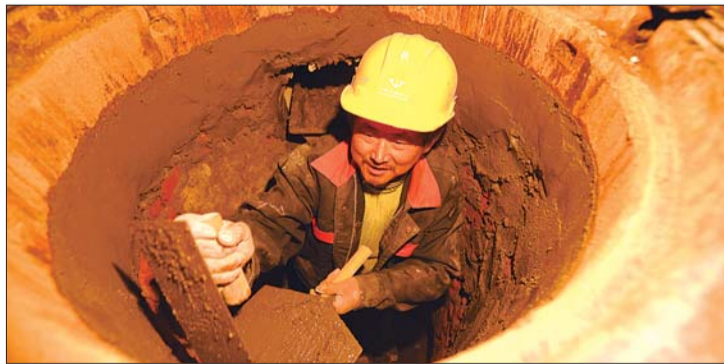
13日深夜,山大路,河南常师傅在3米深井中维修管道。本报记者 张中 摄
