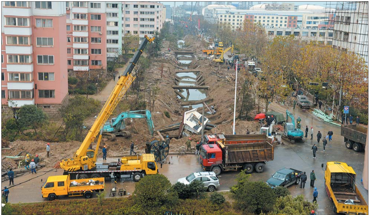
11月24日,各路人马在斋堂岛街中石化黄潍输油管线爆燃事故现场进行清理工作。当日,中石化黄潍输油管线爆燃事故现场聚集了部队、公安、供电、排水、燃气、供水、供热、市政规划等多路人马,对事故现场进行攻坚清理。 新华社记者 冯杰 摄
