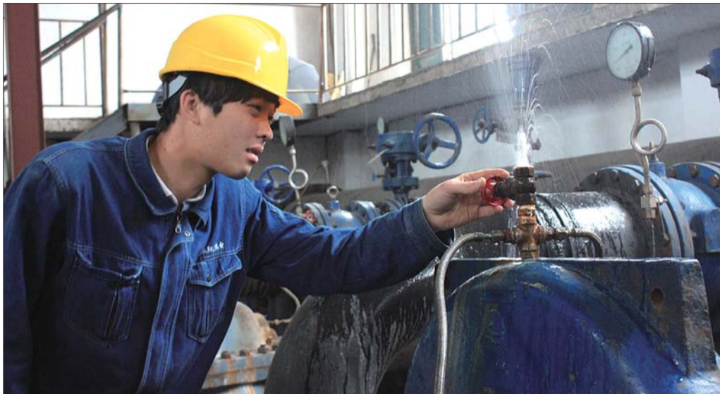
日照阳光热电有限公司的工作人员在循环泵上开阀排气。 本报记者 李玉涛 摄
