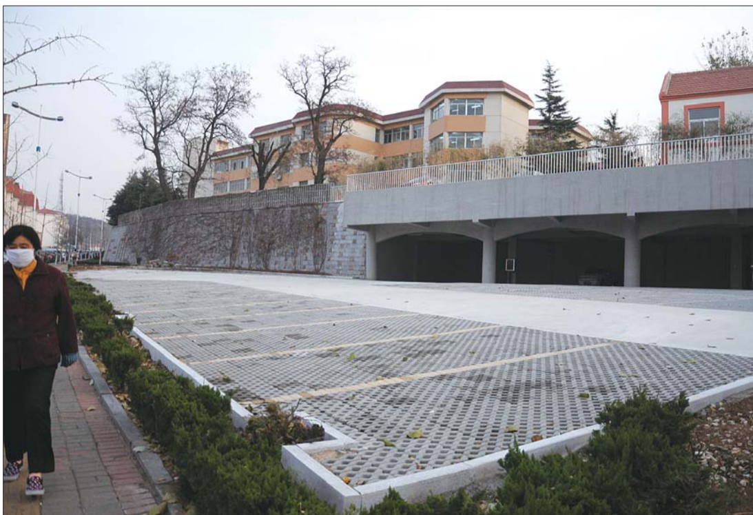
2013年11月中旬,烟台一中新停车场工程已经验收完毕,但使用还得等一段时间。本报记者 韩逸 摄
