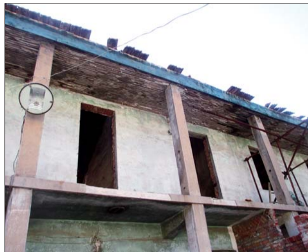
屋顶上的瓦片摇摇欲坠。孟杰 摄
