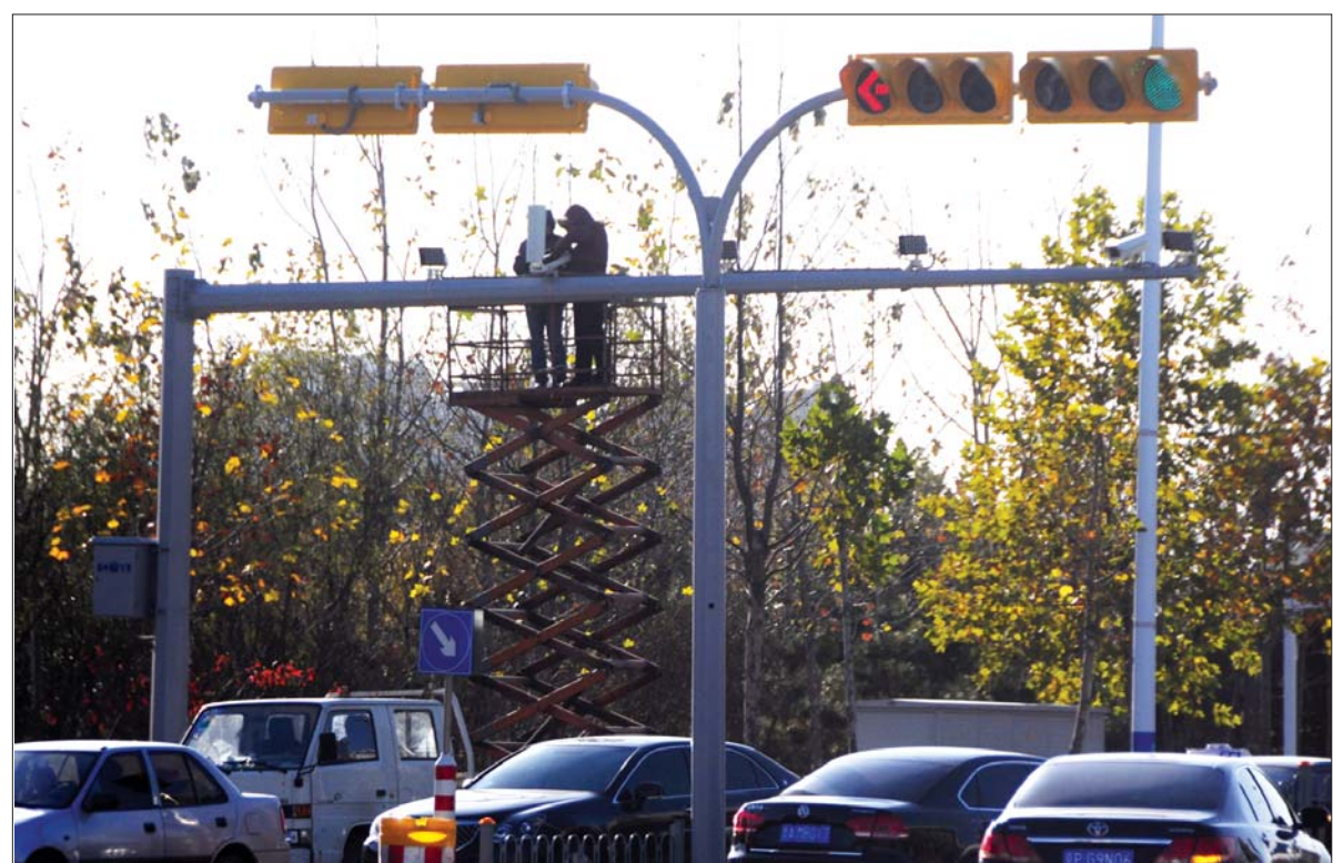
今年,德州市交警部门对市区路口安装监控设备,大部分已经安装完毕。11月27日,技术人员在对三八路与康博大道路口处的监控设备进行调试。 本报记者 马志勇 摄
