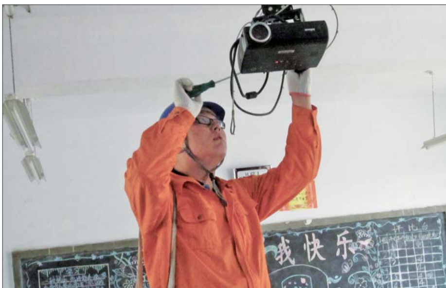
11月26日,文登宋村中学、宋村完小的用电线路、配电室、变压器、配电盘接受宋村供电所“善小”服务小分队的全面巡检。360米老化线路、35个不合格开关或插座被全部更换。
