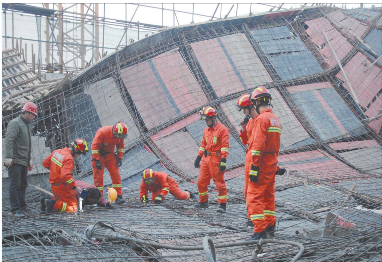
事故坍塌现场。孙婷婷 摄
