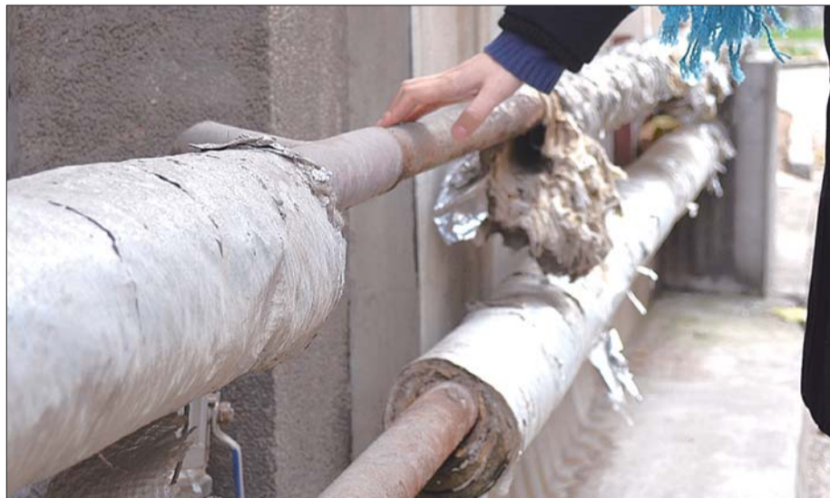
部分老旧小区的供暖设施陈旧,出现破损增加了热损耗。 本报记者 王光营 摄
