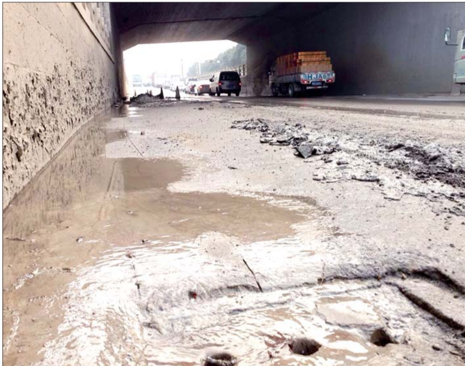
桥涵底部出现多处渗水。本报记者 张林 摄
