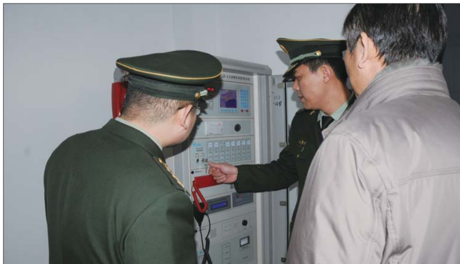
检查人员对淄博剧院消防控制室内的中控柜进行检查。本报记者 姜文洁 摄
