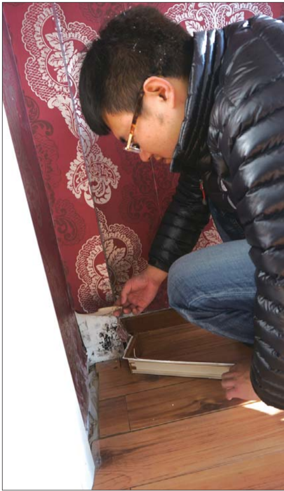
墙面还留着被水淹过的痕迹,凸起的这一块包裹的就是雨水管。 本报记者 张晶 摄
