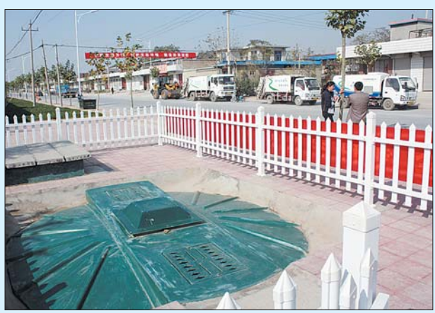
新建的污水处理站
