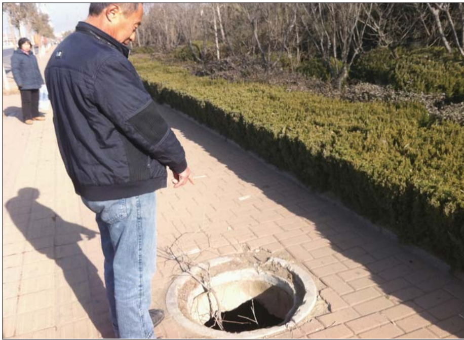
1月1日晚上8点左右,于先生就是掉进了这个丢失井盖的井里。本报记者 尹海涛 摄
