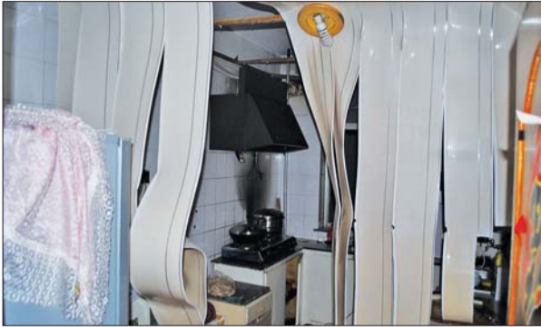
厨房的塑料材质天花板因火苗烧致脱落。记者 吕秀全 摄
