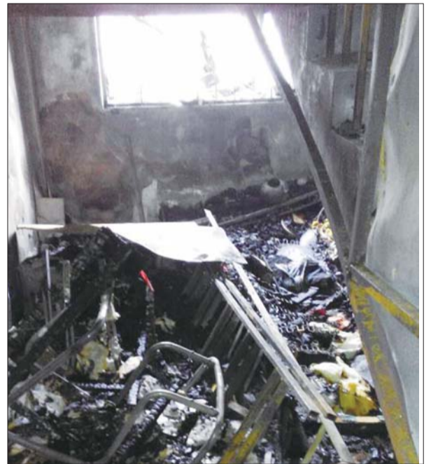
着火的储物间内,物品都已被烧成灰烬。
