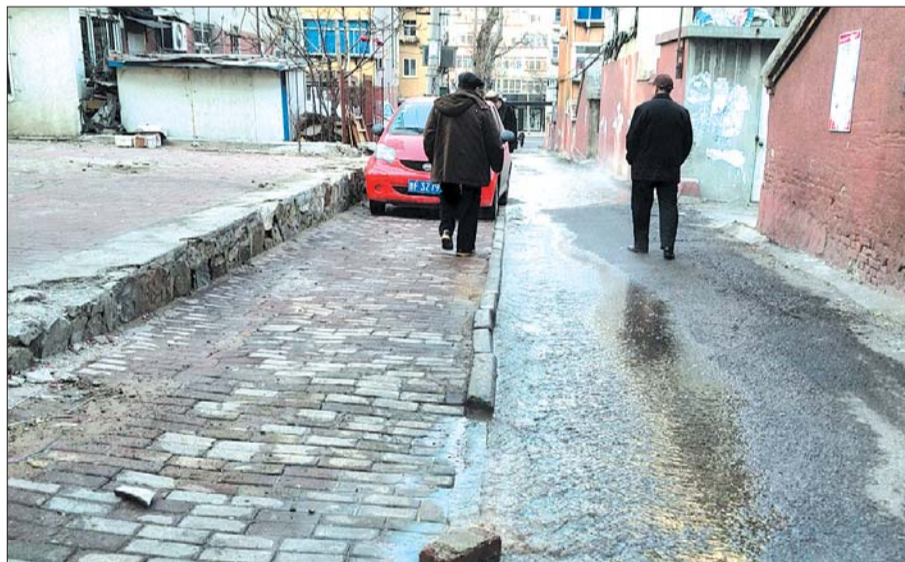
白秋街一处地下暖气管坏了,街上淌满了水。本报记者 张倩倩 摄
