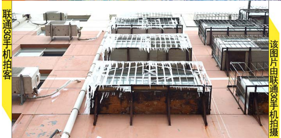
楼上漏水四五天,楼下窗户上挂“冰瀑”。本报记者 邢志彬 摄
