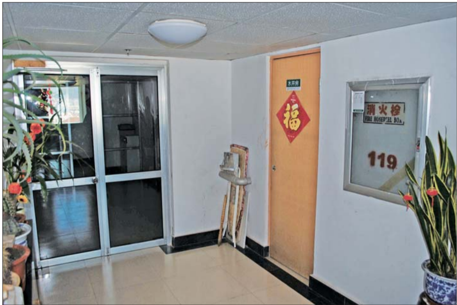
防火门被换上了铝合金门,消防栓被锁门内。 记者 吕修全 摄
