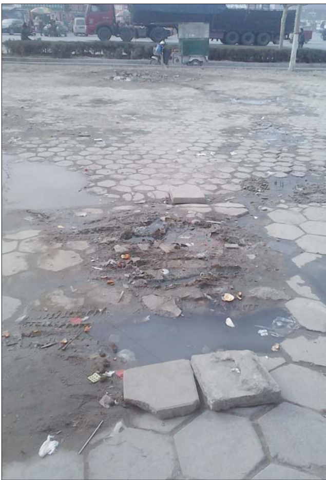
▶24日下午3点,在市民反映的地点,记者看到,由于下水道堵塞,不少污水流上了街头。
