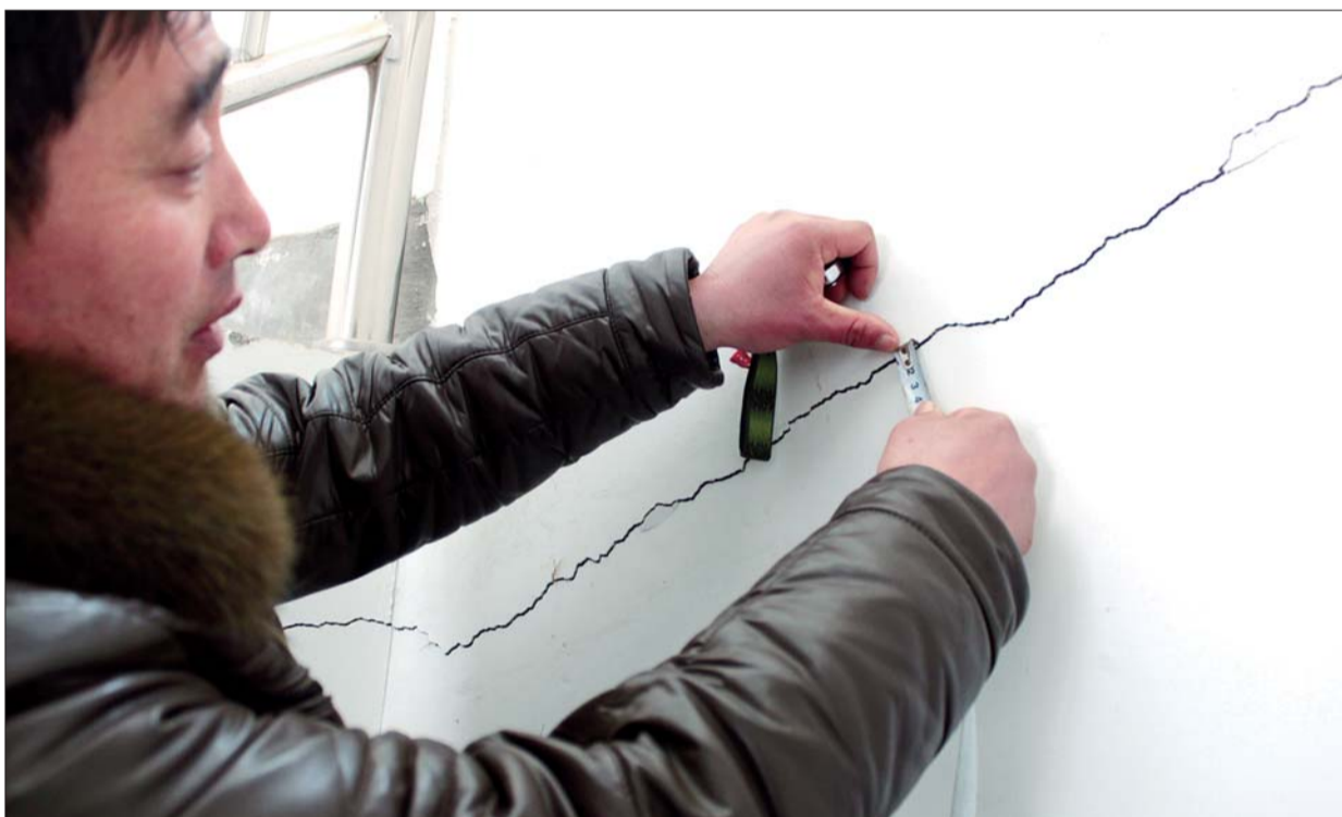
裴先生用卷尺测量裂纹的宽度。
