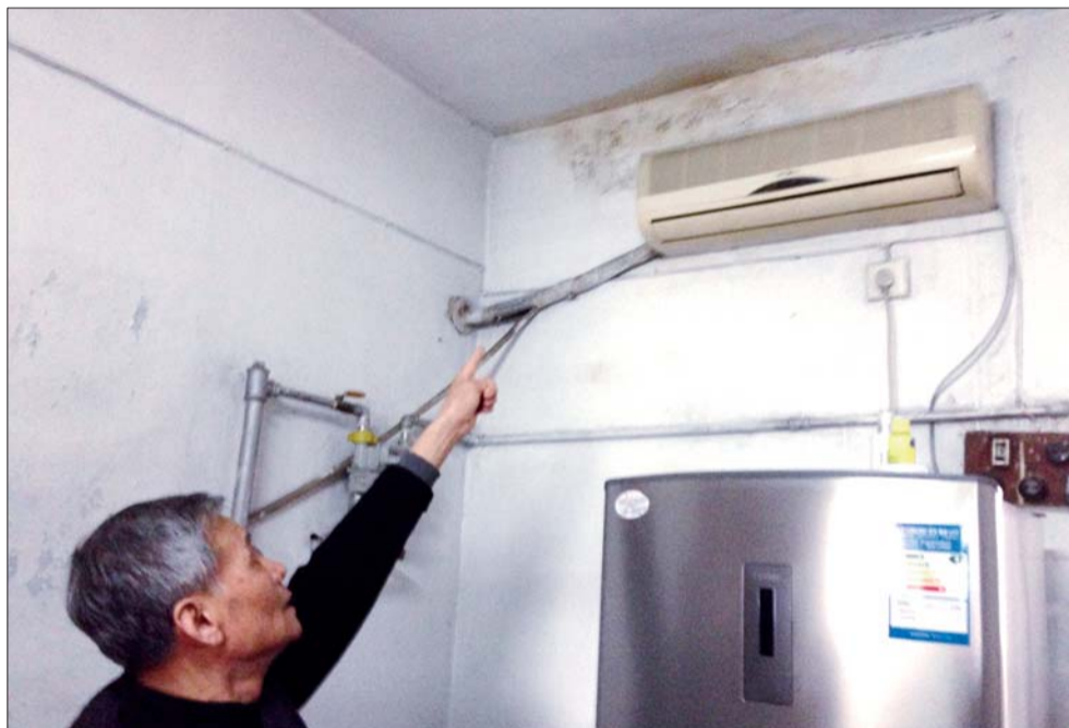
房顶漏水,居民苦不堪言。张林 摄
