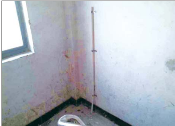
从1楼到6楼,每层楼梯拐角处地板上都被钻了孔。 本报记者 苑菲菲 摄
