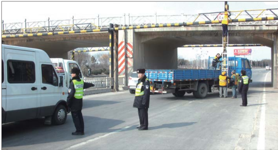
铁路部门的工作人员正在维修被撞的限高杆。 线索人供图
