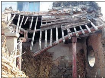
戏楼已近坍塌。
