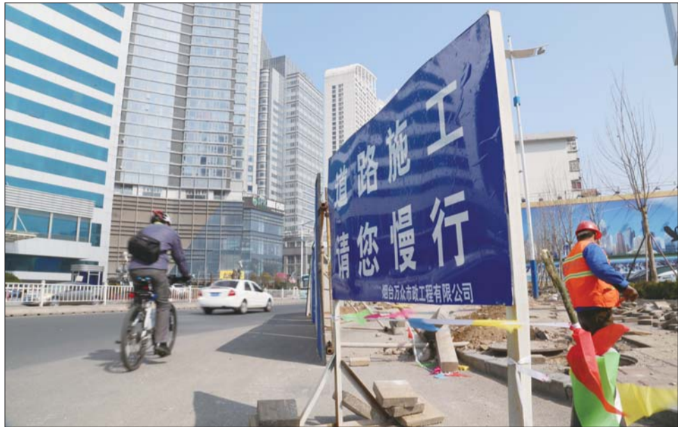
3月11日,三马路路面拓宽工程正式开始施工。市政施工人员介绍,工期预计要两到三个月,第一步是移动通信电缆。提醒过往车辆注意慢行。
