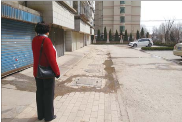
开发区金城小区一车库已经往外流了一周脏水了。本报记者 张倩倩 摄
