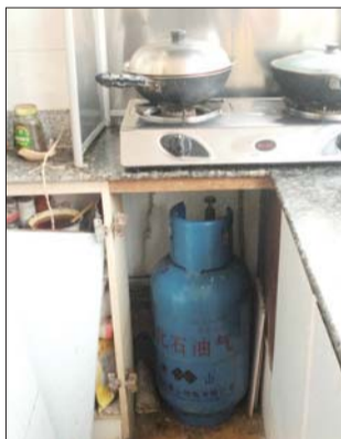
东南街2号楼居民家中,至今都只能用液化气罐做饭。本报记者 王敏 摄
