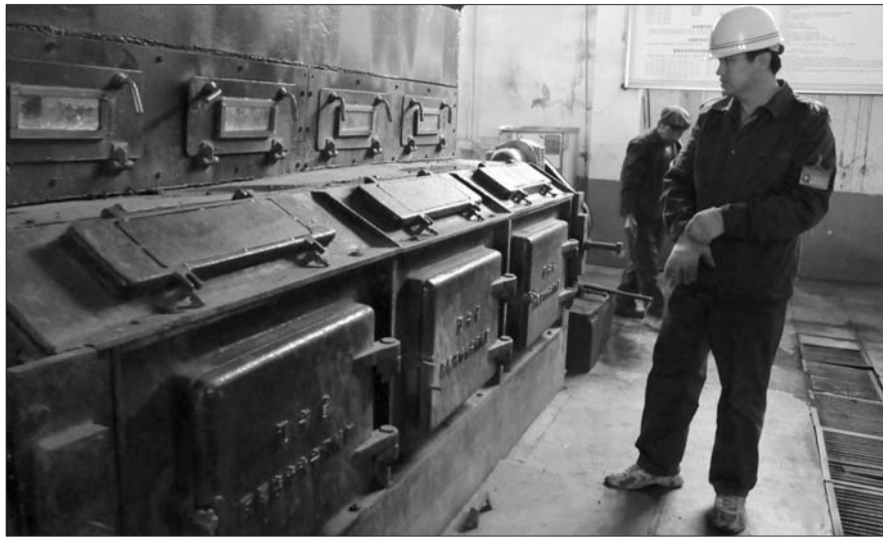
开始低温调试后,工作人员需要定时在锅炉窗口观察。 本报记者 韩逸 摄
