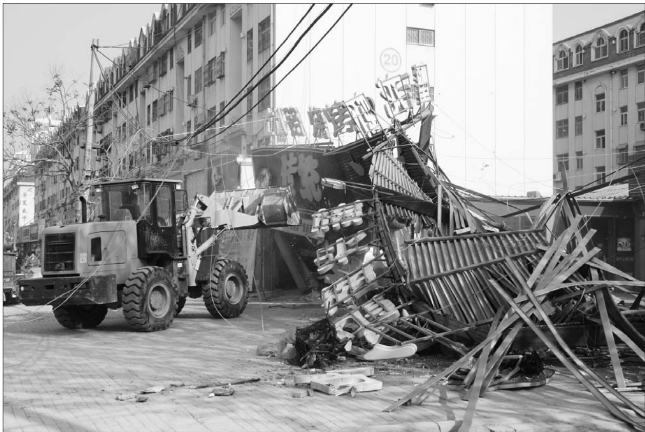
执法人员拆除振兴西路土八路烧烤私自搭建的违章建筑。 本报记者 张召旭 摄
