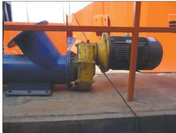
部分设备上的油漆剥落,露出斑斑锈迹。
