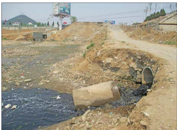
又发现一处向水库排污的污水口。 本报记者 蒋龙龙 摄
