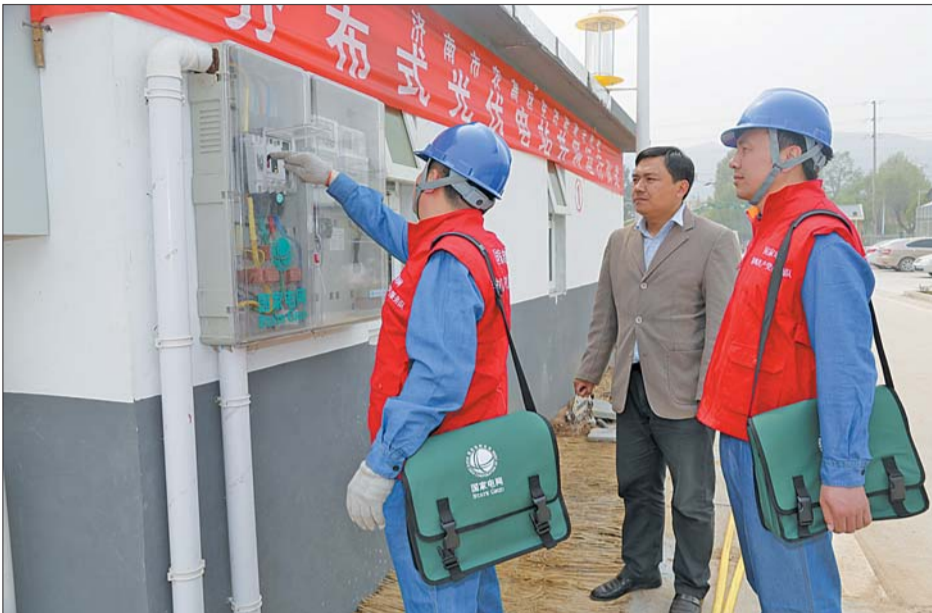
工作人员正在园区内调试电表。
