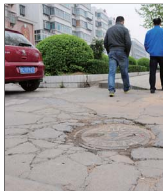
越来越多的外在压力通过路面传导给地下管道,使地下管道爆裂的危险系数增大。 本报记者 姜文洁 摄
