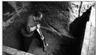
城中小区19号楼已经开始更换新水管。 本报见习记者 陈姿彦 摄
