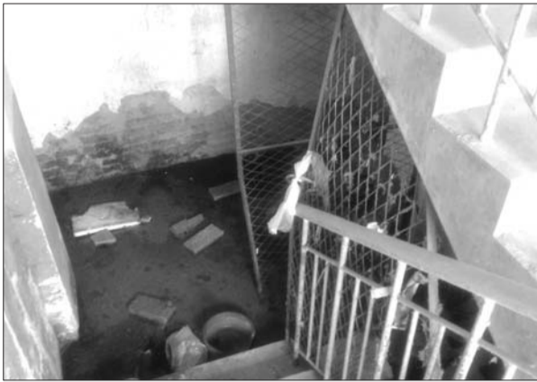
机场路42号附13号楼的地下室里充满了污水。本报记者张明媛 摄
